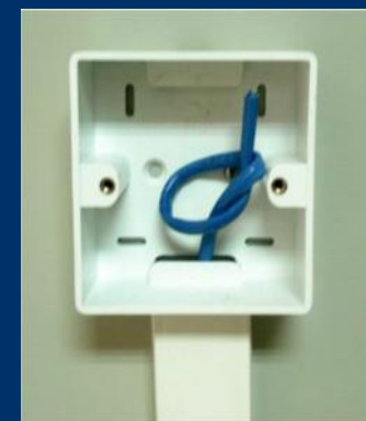
装修墙面明装底盒
